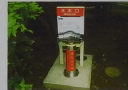
連結送水管改修工事完了に伴う新消火栓
